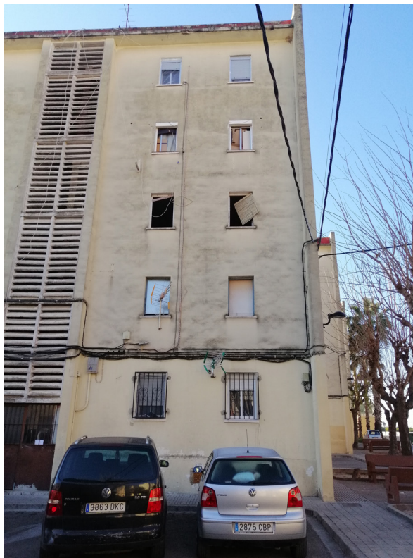
Imatge 7. Edifici en mal estat del Grupo José Sales. Font: foto pròpia.
