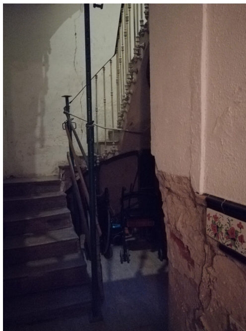
Imatge 8. Escala en mal estat en edifici de reallotjament. Font: foto pròpia.
